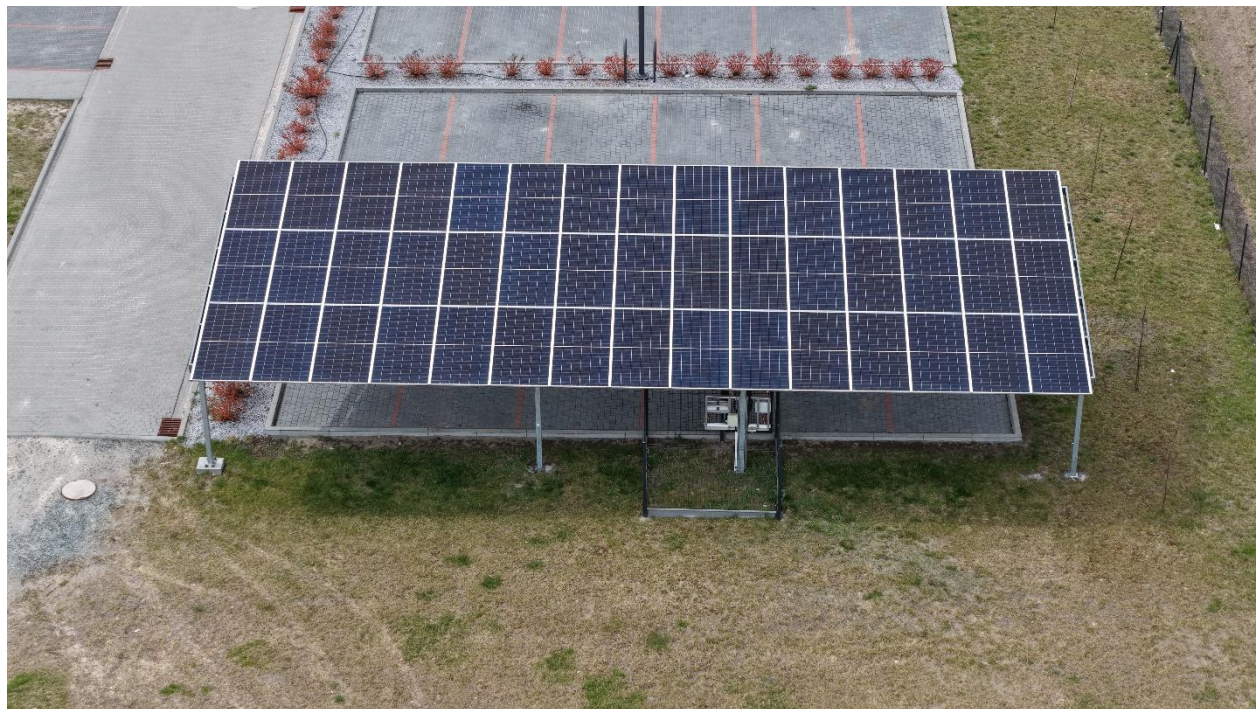
Opis zdjęcia: realizacja instalacji PV na parkingu (carpot) przy Urzędzie Gminy Wilczyn, źródło: Gmina Wilczyn
